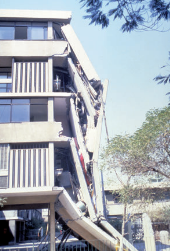
La Villa Olímpica, en Santiago, sufrió importantes daños a raíz del terremoto de 1985, situación que se repitió 25 años después, con el sismo del 27F. Crédito: National Information Service of Earthquake Engineering (NISEE), University of California, Berkeley
