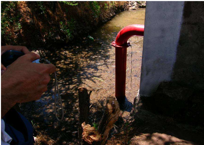
Foto 5: Casa de bombas Buda donde se extrae agua transportada por el pretil norte Fuente: CONAMA RM
