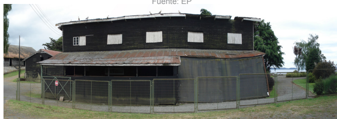
2-Galpón pañol, estado de conservación Crítico Fuente: EP
