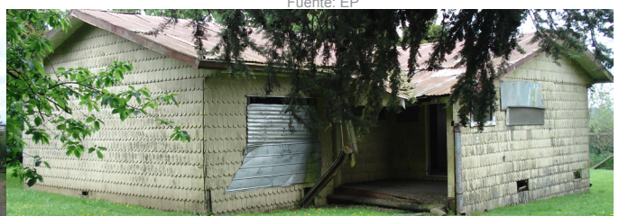
6-Casona capataz, estado de conservación Crítico Fuente: EP
