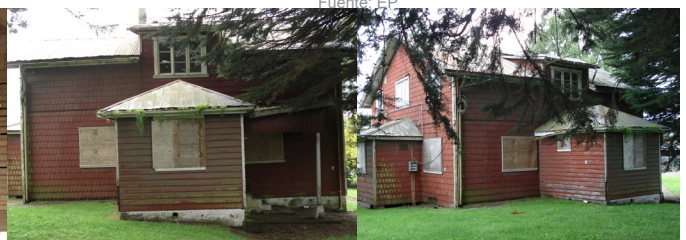
5-Casona Administrador, estado de conservación Crítico Fuente: EP
