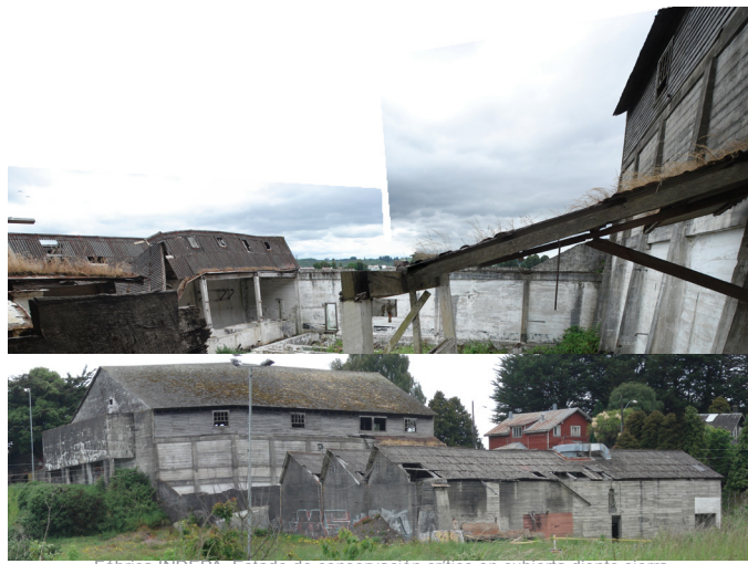
Fábrica INDEPA, Estado de conservación crítico en cubierta diente sierra Fuente: EP
