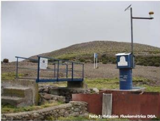
Foto 3: Estación Pluviométrica DGA.
